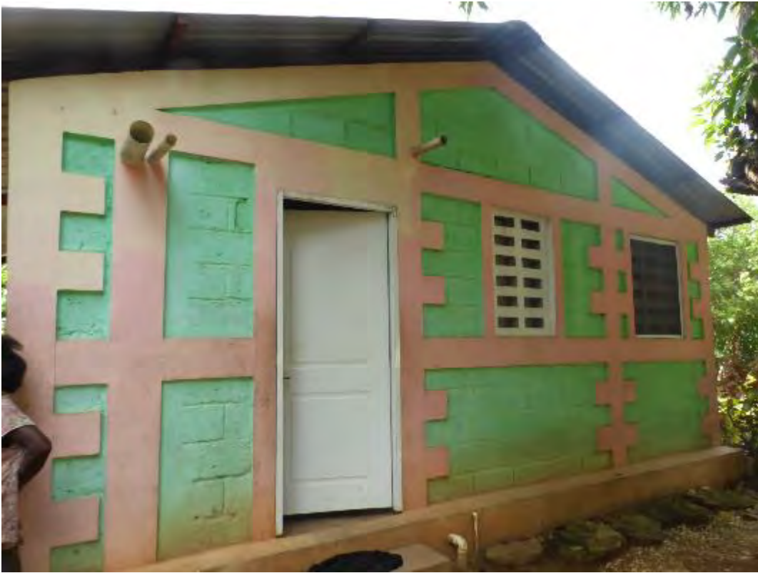
Maison Maçonnerie Chaînée « UMCOR » sans dommages. Les poteaux de la citerne en béton ont été endommagés.
