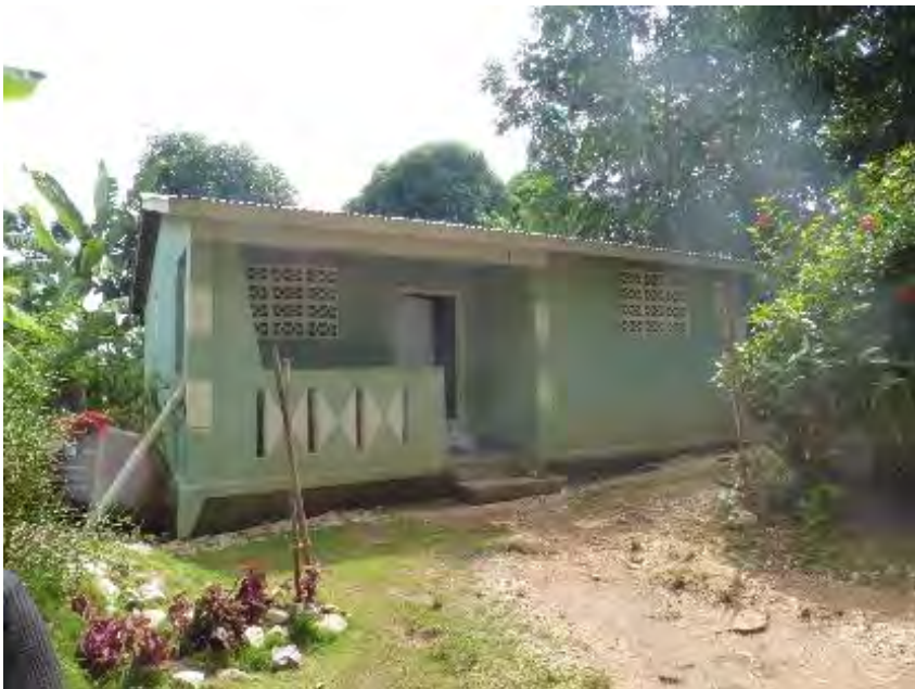
Maison « FFTP » avec peu de dommages
