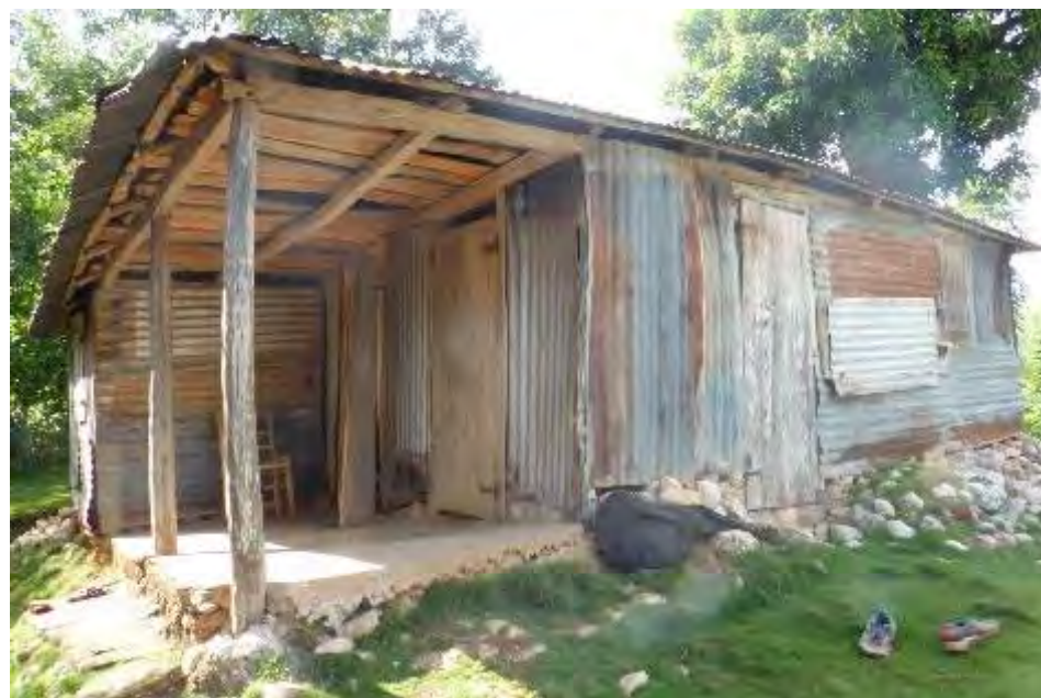
Maison OB traditionnelle endommagée par Matthew (toit, remplissage) et réparée avec des tôles. Elle n'a pas été endommagée par le séisme. Les poteaux sont en bon état général.
