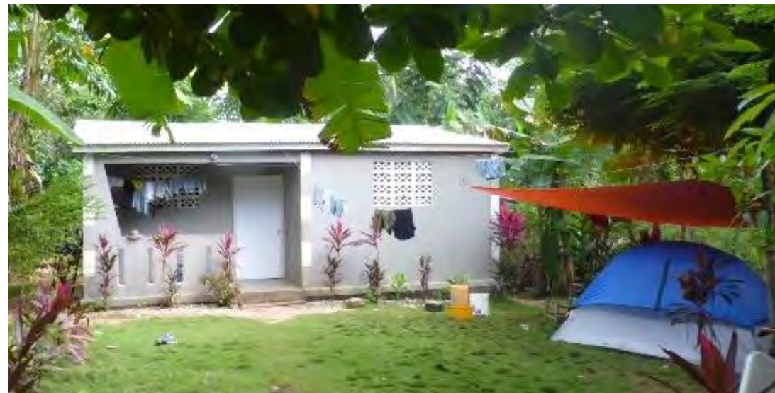
Maison « FFTP » endommagée. Les habitants dorment dans une tente.
