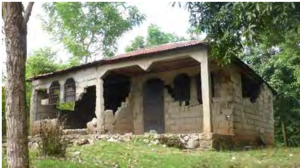
Maison en maçonnerie simple de blocs très endommagée
