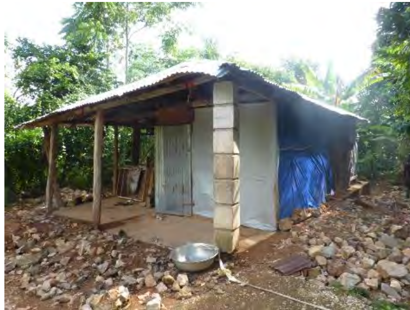
Maison OB traditionnelle endommagée
