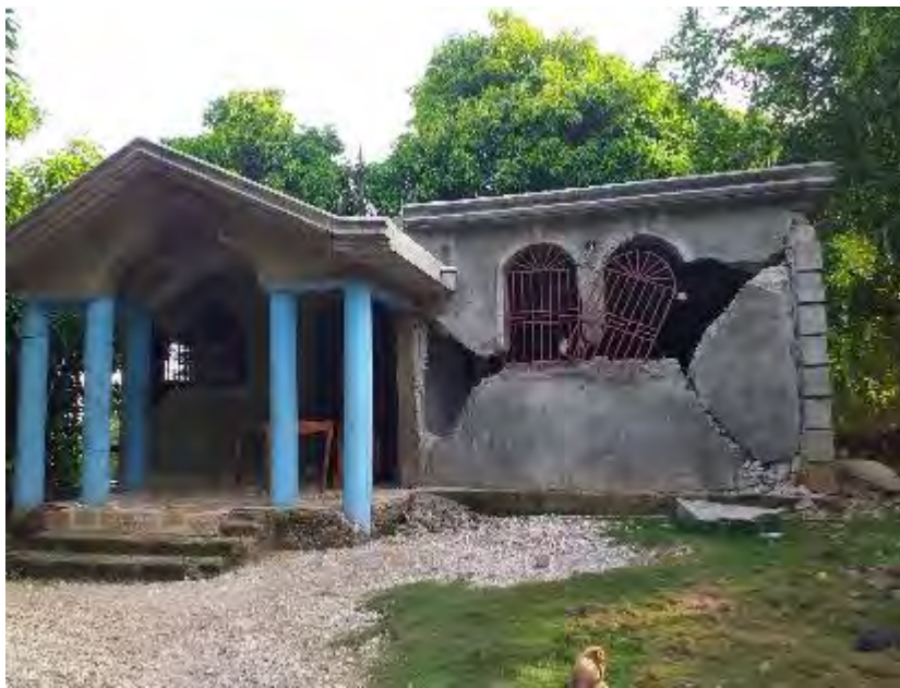
Maison en ossature béton et maçonnerie de blocs endommagée
