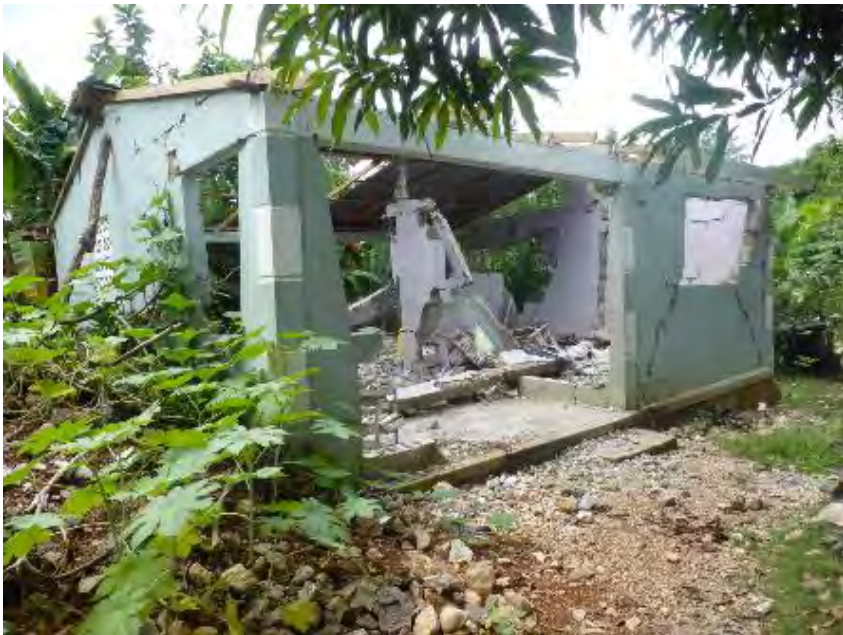
Maison « FFTP » très endommagée
