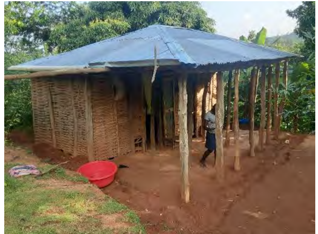
Maison OB traditionnelle avec remplissages en clissage, en cours de construction. Elle s'est un peu inclinée mais n'a pas subi d'autres dommages.
