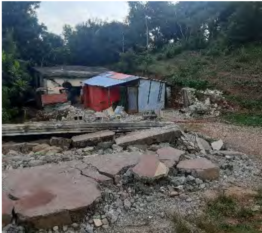
Deux maisons en ossature béton et maçonnerie de blocs avec dalle béton détruites et très endommagées
