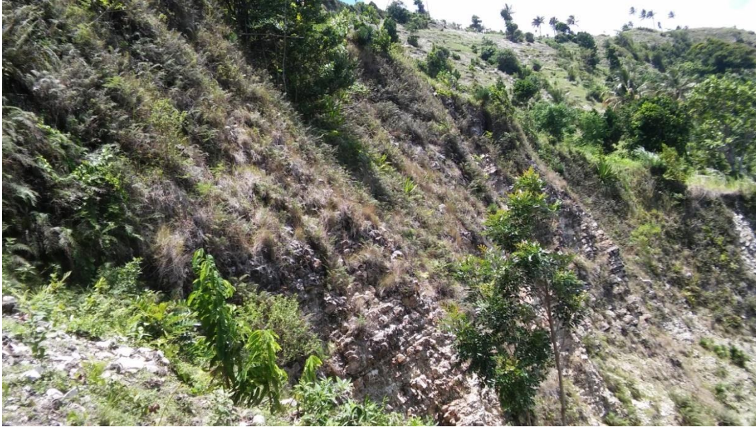
Eboulement spontané dans le marno calcaire en banc décimétrique
